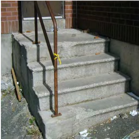
Uneven stairs - tripping hazard
